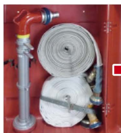
スタンドパイプとホース
