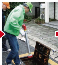
消火栓に差し込む
